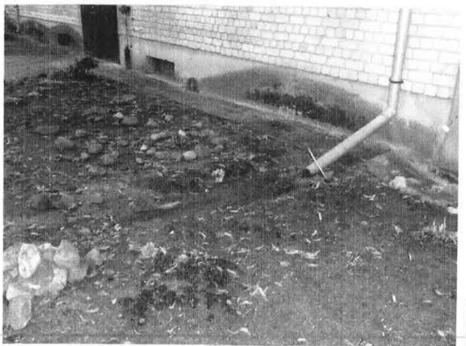
Fasadinių sienų mūro siūlės vietomis ištrupėjusios. Rūsio langai visiškai susidėvėję. Lietaus vanduo nuo stogo išleidžiamas šalia pastato
