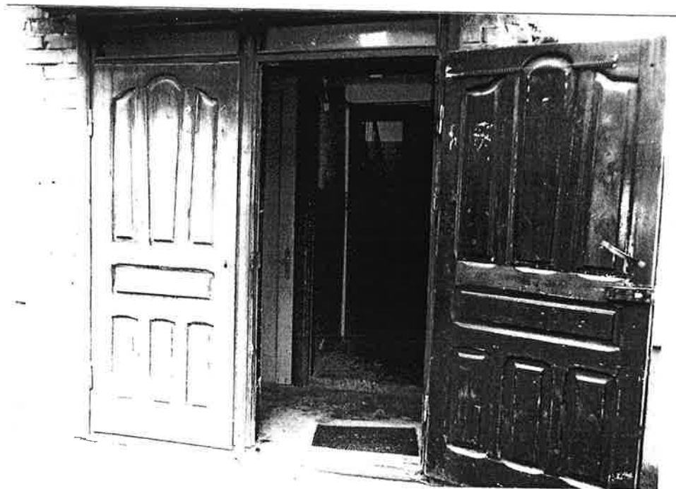
1-os laiptinės lauko durys senos, susidėvėjusios. Rūsio langai seni. Nuogrinda sulūžinėjusi
