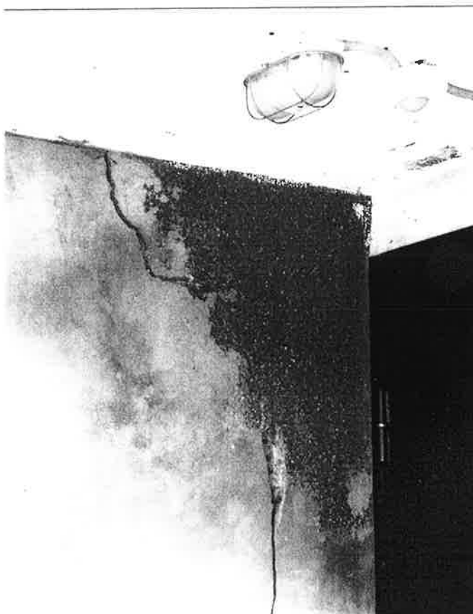
Ištrupėjusios keraminės plytos viršutiniuose aukštuose. Trūkimas įėjimo į laiptinę stogelį laikančioje sienoje
