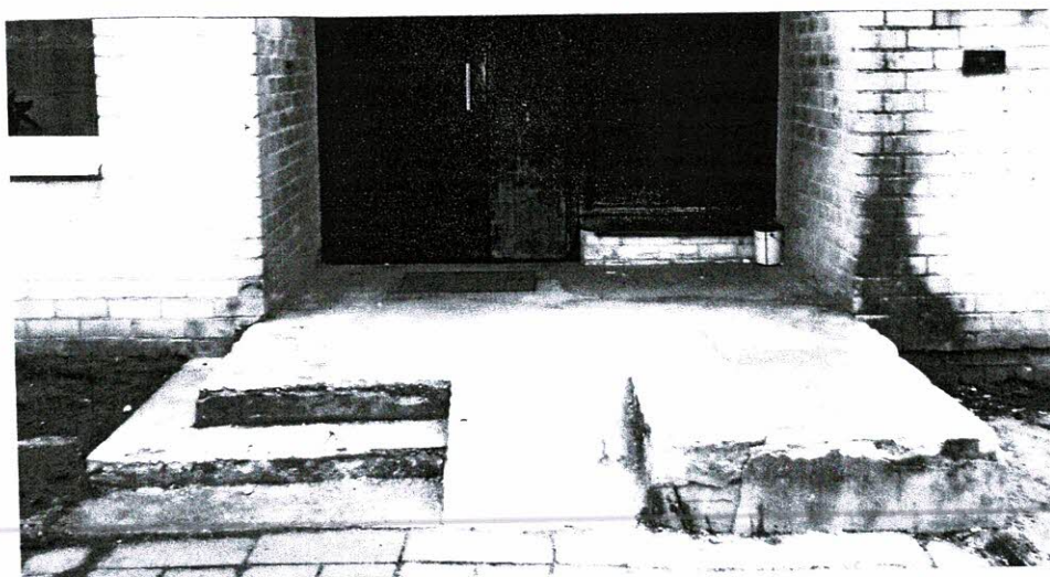
lėjimų į laptines pakopų ir aikštelių betonas išsidėvėjęs. Stogelio apatinis apdailinis sluoksnis suiręs, armatūra atvira
